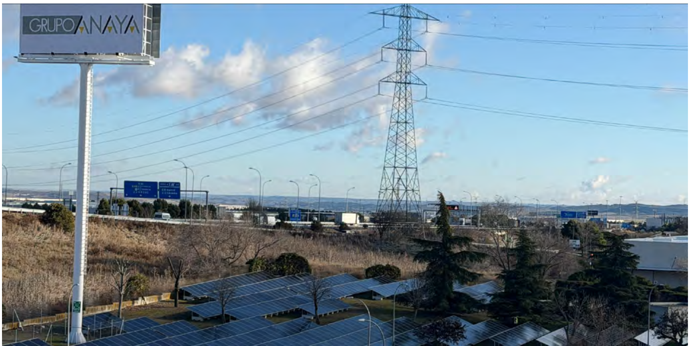
Installation de panneaux solaires sur le site logistique à Getafe en Espagne (Grupo Anaya).
